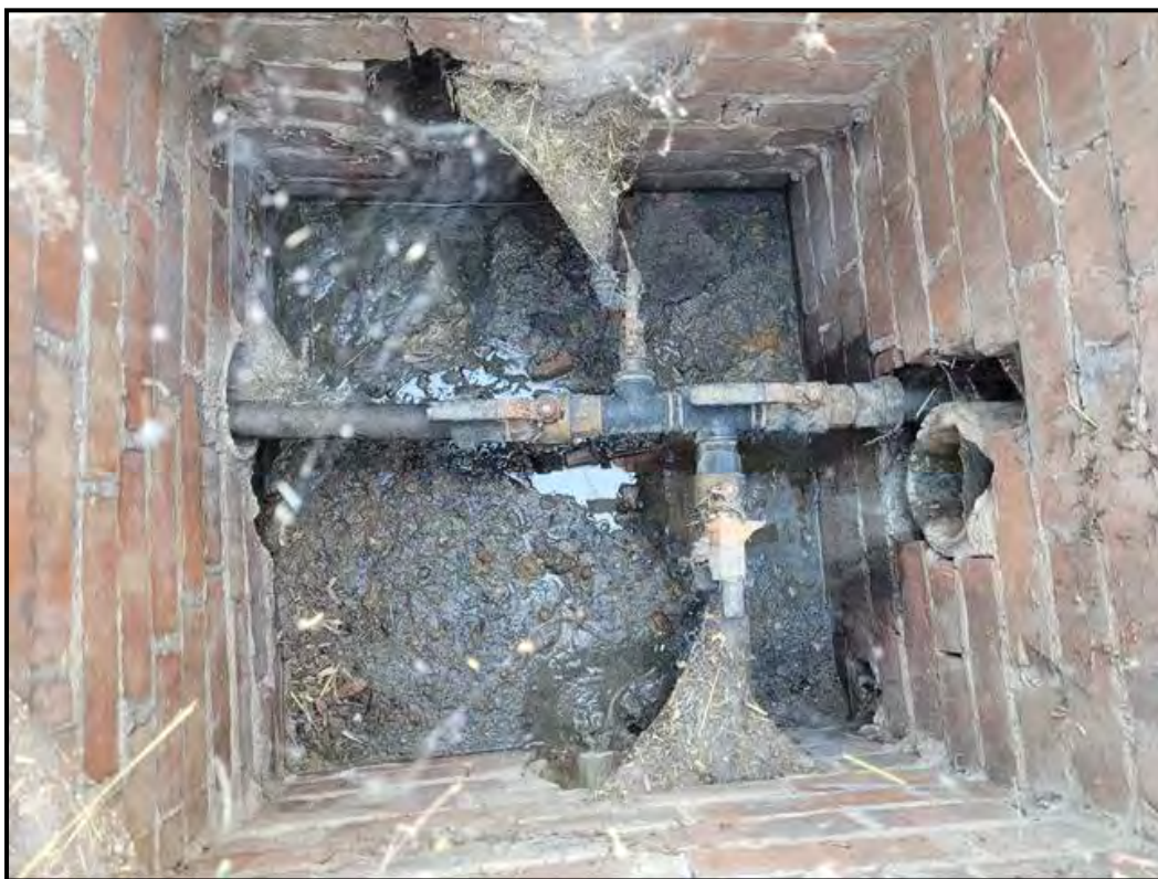
Arqueta corte de ramales situada junto a la carretera BU-601
