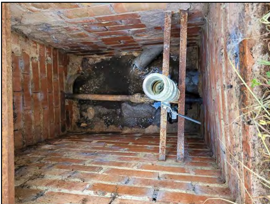
Arqueta corte de ramales situada junto a la plaza mayor
