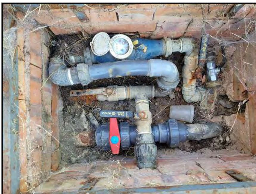
Arqueta de válvulas y contador entrada a depósito
