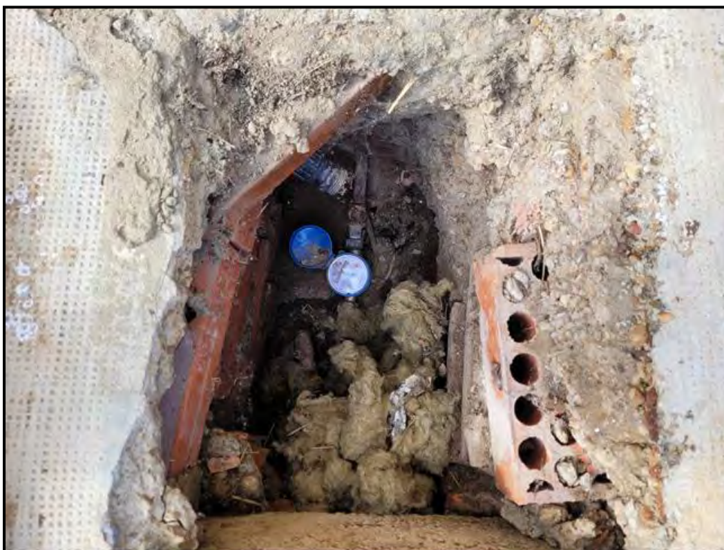
Arqueta y contador acometida domiciliaria
