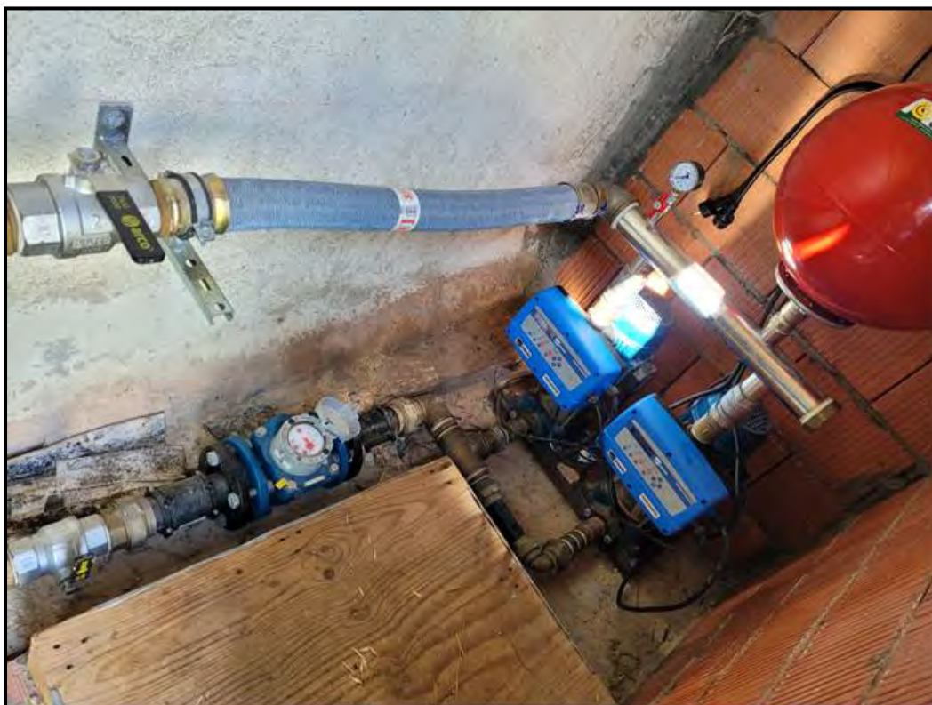
Grupo de presión sin servicio en el interior de la caseta del depósito
