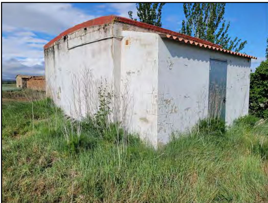
Depósito regulador de 60 m 3
